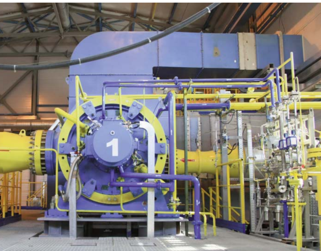
Газоперекачивающий агрегат на одном из объектов ПАО «Газпром»
